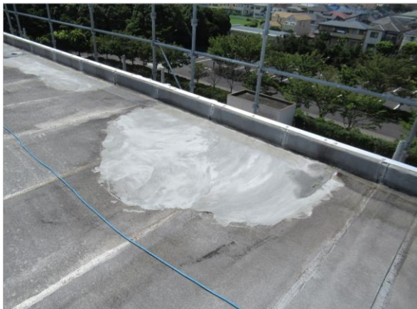
屋上 水たまり箇所 不陸調整
