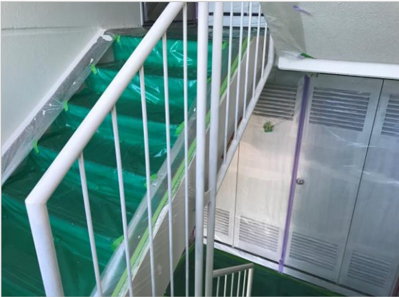
階段手摺 サビ止め
